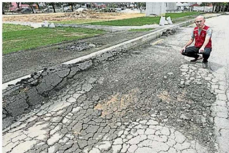
林立迎巡視增江北區一處嚴重損壞的路段。
