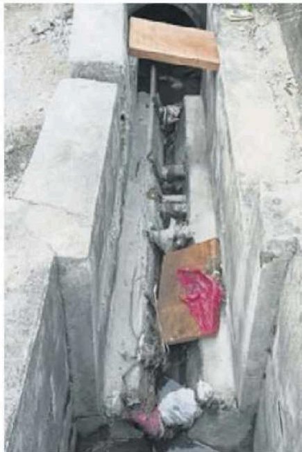
■增江阿曼5路的塌陷處, 造成溝渠結構受影響, 居民指市政局人員僅修復一次, 再沒有下文。
