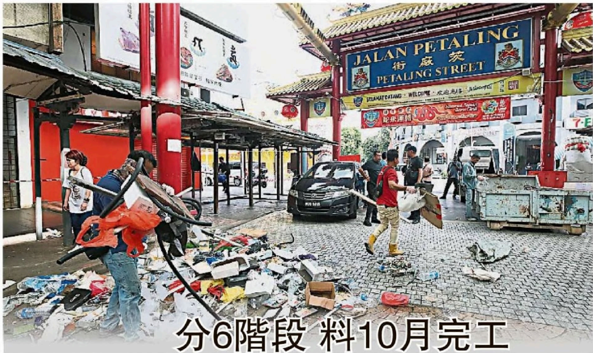
人员忙着清理摊位留下的垃圾。(黄冰冰摄) 40个摊位，率先展开第一阶段的提升工程，图为工作 靠近茨厂街牌楼（面向敦陈祯禄路）左右两旁的
