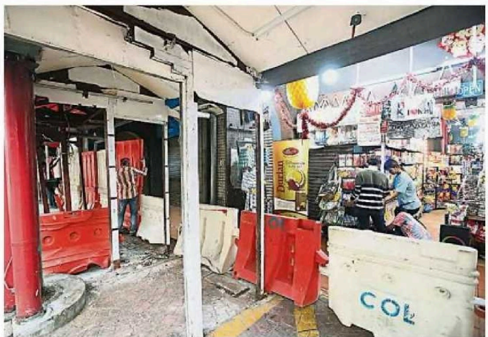
施工期间，工地旁的店铺可如常开店，民众也只能在商店前的走廊通行，不可进入工地范围。(黄冰冰摄)
