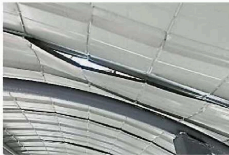
行人天桥的顶棚已有漏水情况。
