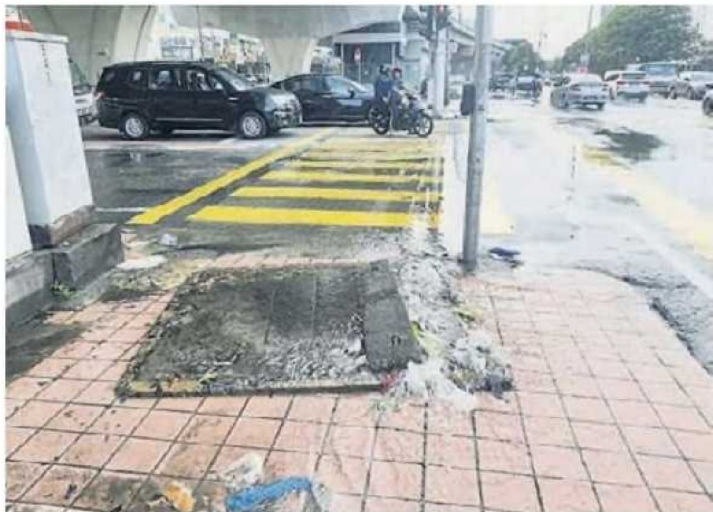
■分岔路口旁安全岛下方的地下水管，凌晨突然破裂，造成水流溢出路面。（图由余保凭提供）
