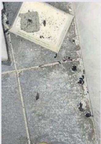
■厨房和食品储藏架有老鼠粪便和蟑螂的踪迹。
