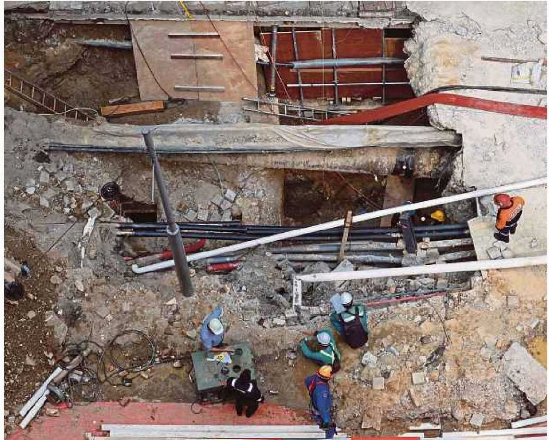
Kejadian tanah jерlus di Jalan Masjid India pada 23 Ogos tahun lalu menyebabkan seorang warga India, hilang selepas terjatuh di dalam lubang sedalam lapan meter. (Foto fail BERNAMA)
