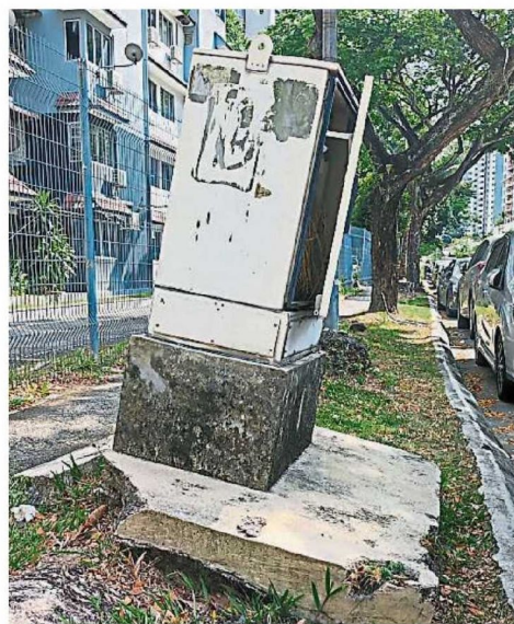
樹根導致路邊的電力設備箱嚴重傾斜，且箱門半開，電線也已外露，對行人及車輛都有潛在安全隱患。
