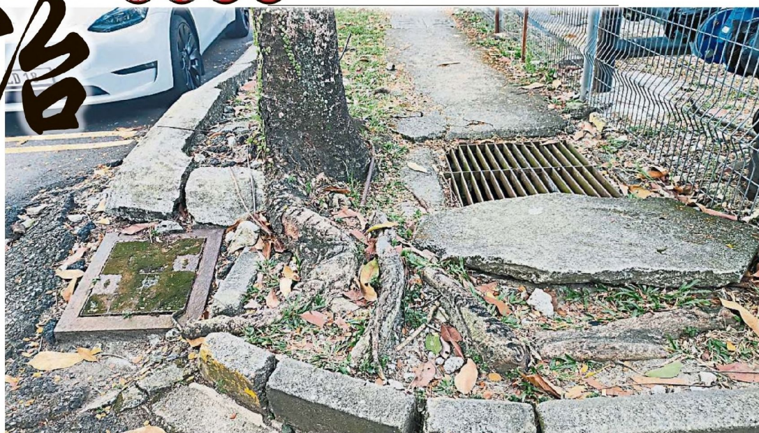
組屋入口處前的老樹根把水泥及磚塊破壞殆盡。
