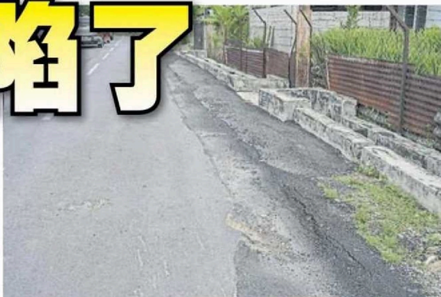
■甲洞增江英達13路刚获重铺，却因为工程造成道路发生下陷。
