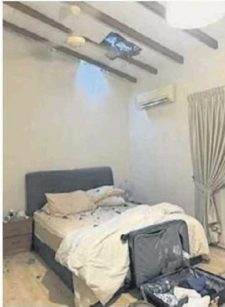
■其中一间卧室的破洞位置正好位于床的正上方。
